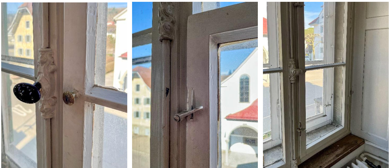
Details der Lüftungsflügel.
