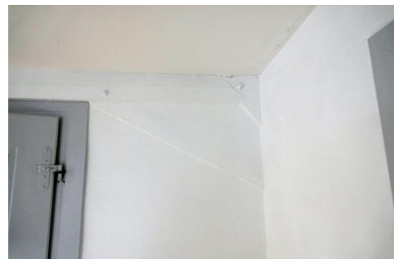
Stuhlstreben und Kopfstreben-Anschluss an Druckriegel Beide Verbindungen mit Zapfen und Holz Nagelsicherung.
