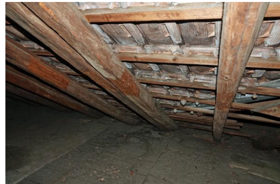
Hausbock und Anobien an den Sparren inaktiv. Bebeilte stellen von Schädlingsuntersuch.
